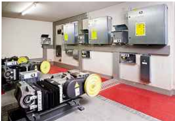
Triplexinstallatie in commercieel gebouw aangedreven door een DR SGB 142 verbonden met een CO MX- schakelkast
